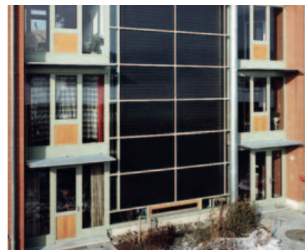
Façade énergétique avec capteurs solaires.
