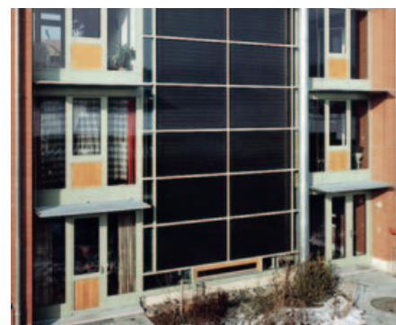
Façade énergétique avec capteurs solaires
