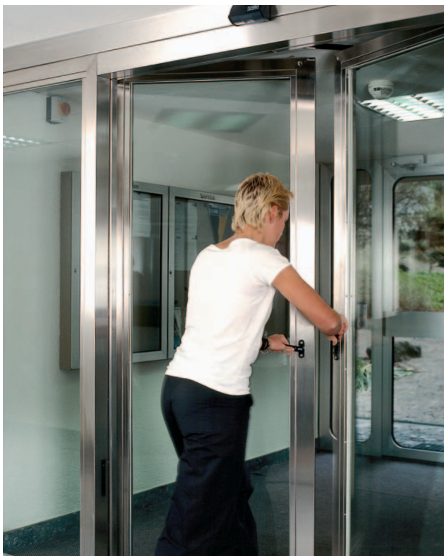
Portes coupe-feu coulissantes automatiques avec vantaux de fuite ouverts
