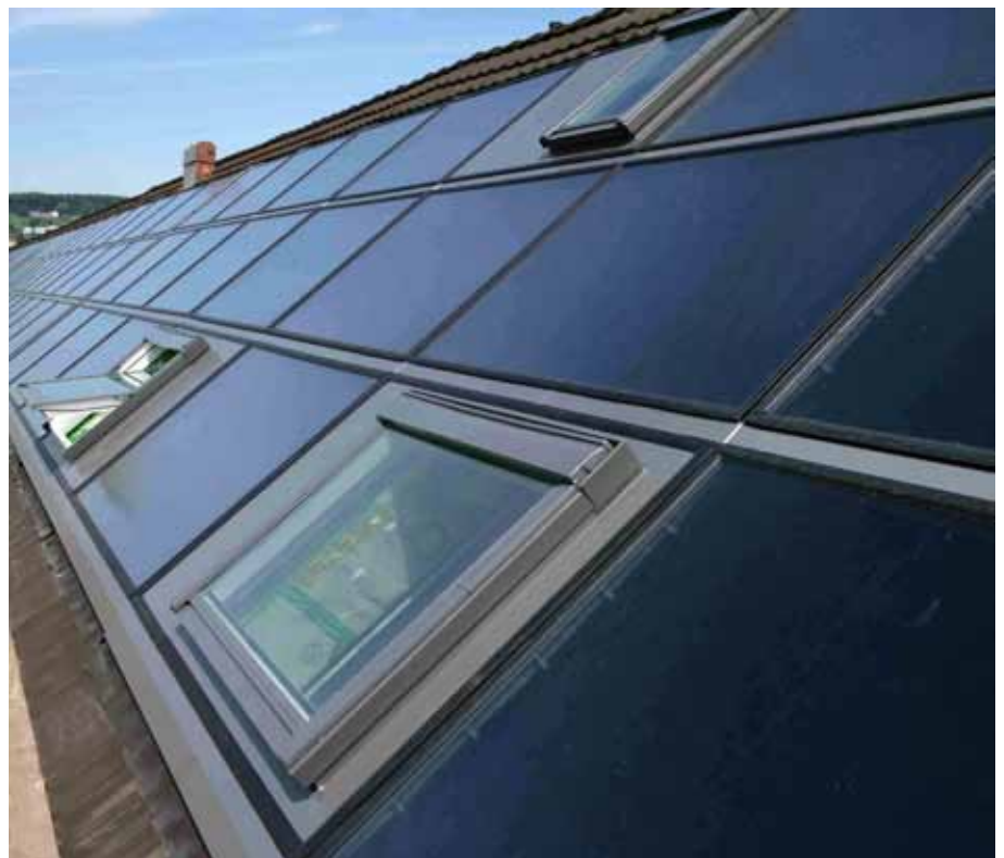
Eine ästhetisch saubere Lösung: Kollektorenfeld mit integrierten Dachflächenfenstern
